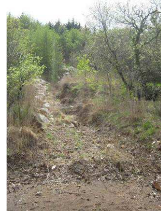
Photo 23 : Fossé drain = exhaure du dépôt de résidus de traitement
